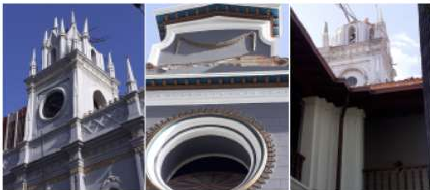
Fig. 5 Daños en la torre del reloj del Palacio de las Academias. En la foto central se aprecia un plano de debilidad en la base de la pared norte de dicha torre.
