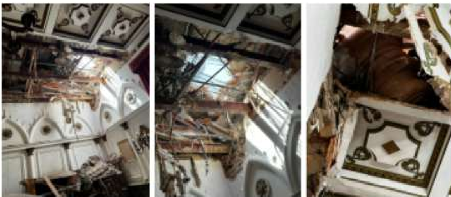
Fig. 4 Daños en el techo del palacio en el área de la Academia Nacional de la Historia causado por la caída de la campana del reloj de la torre en la pared norte.
