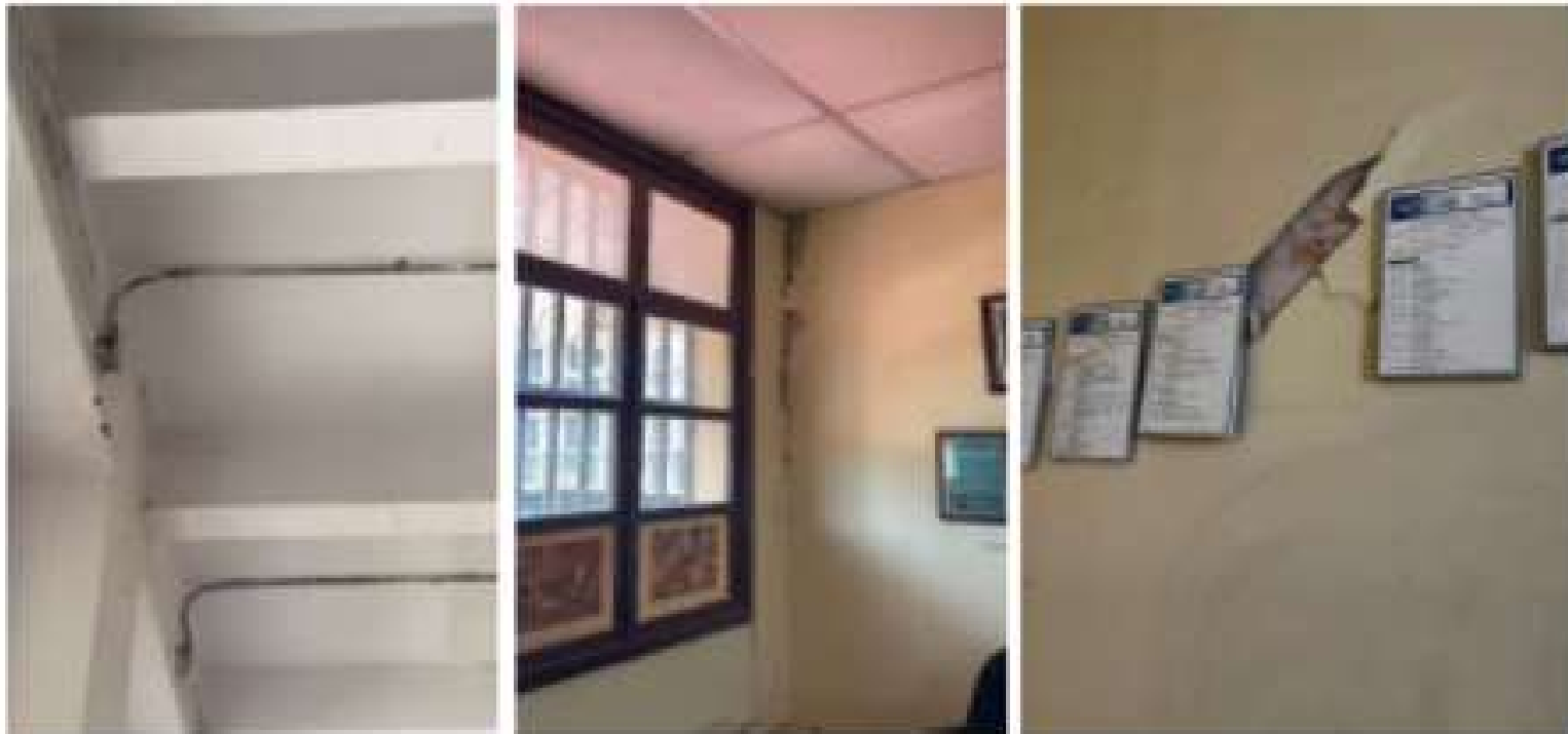
Fig. 3 Daños en algunas de las paredes y frisos sobre vigas en el Palacio de las Academias. Se aprecia que las paredes son de mampostería trabada al igual que en la Iglesia San Francisco.
